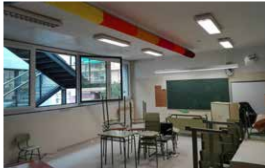
“El Garrofer”. Aulas con ventilación de confort.
