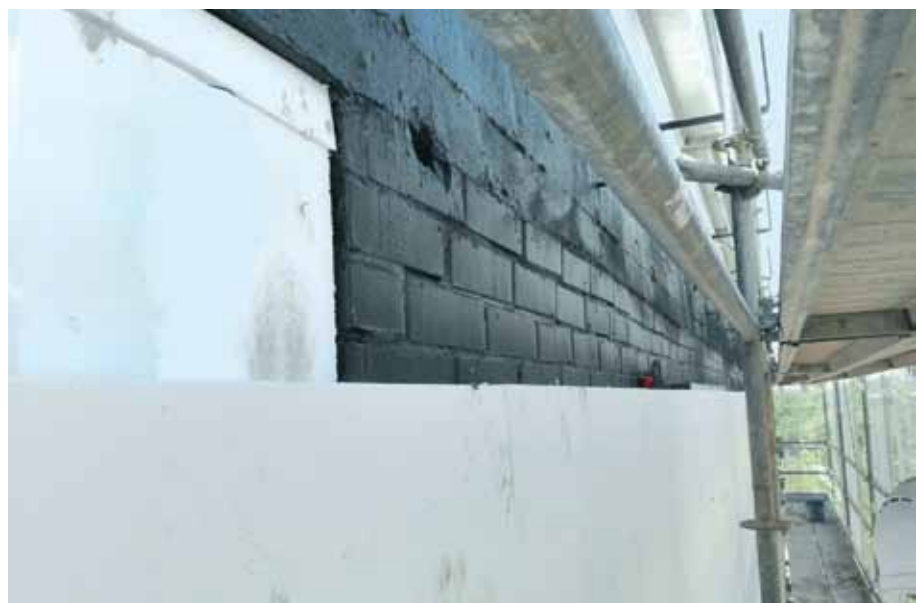
Se aplica en la fachada pintura para la hermeticidad y se coloca el aislamiento térmico.
